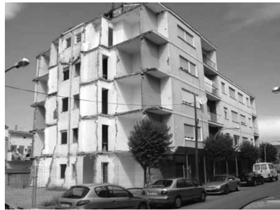
Detall, barri de l'Estació de Sallent, afectat per subsidiències (Foto: Montsalat)
