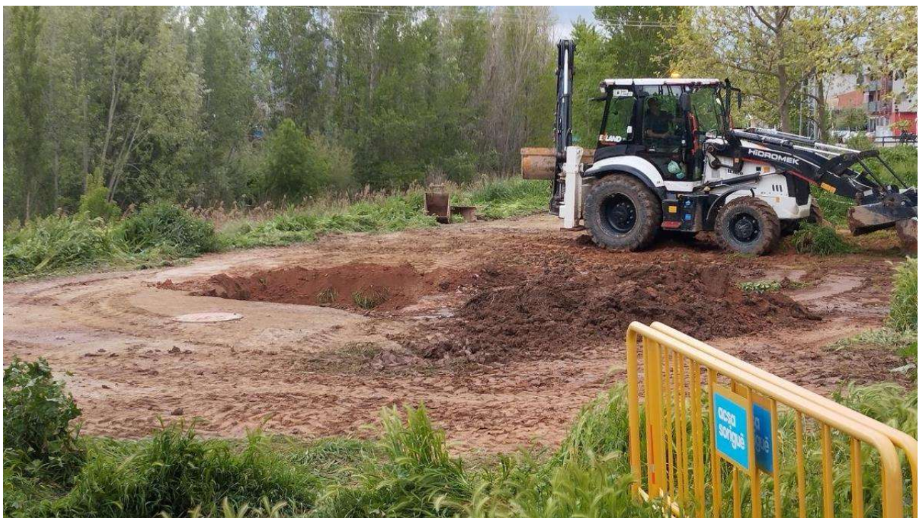
Reparació del vessament del col·lector que va tenir lloc a Sant Joan l'abril passat / ARXIU/DAVID BRICOLLÉ
