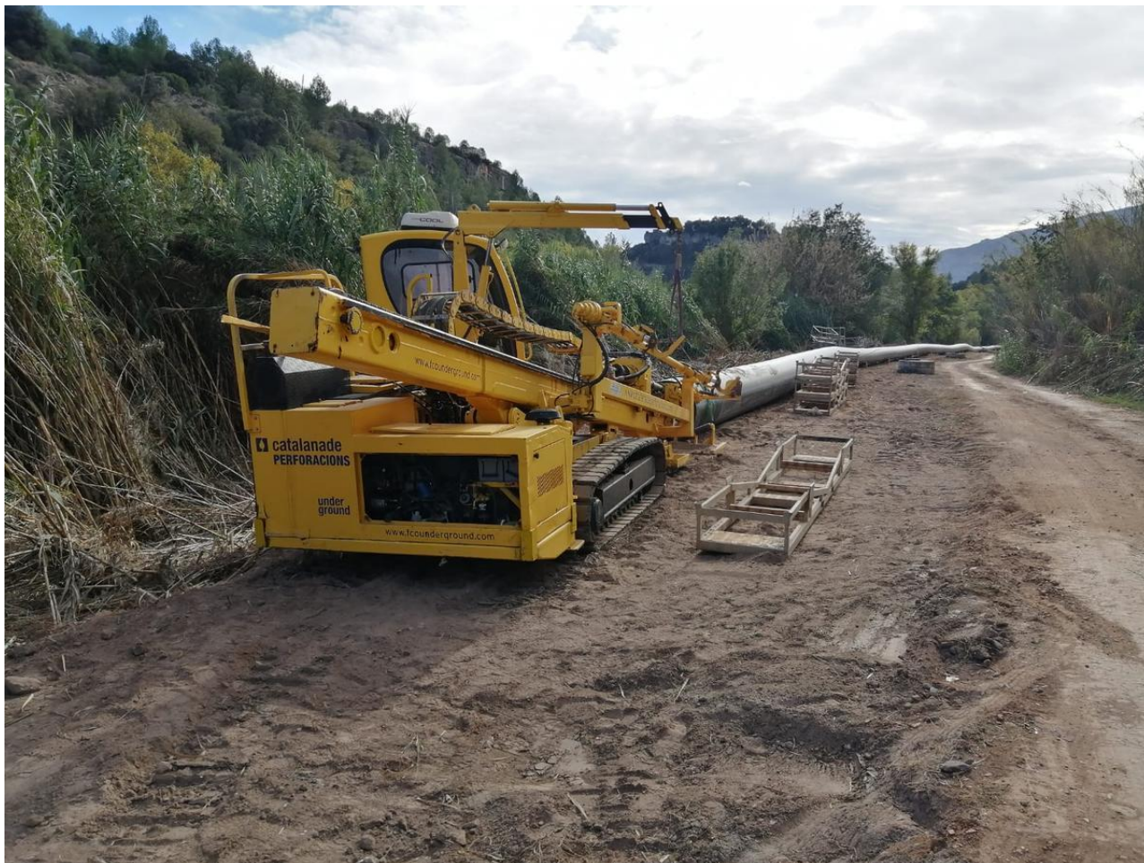
Treballs de construcció del nou col·lector de salmorres en el tram del Bages sud / ARXIU/DAVID BRICOLLE
