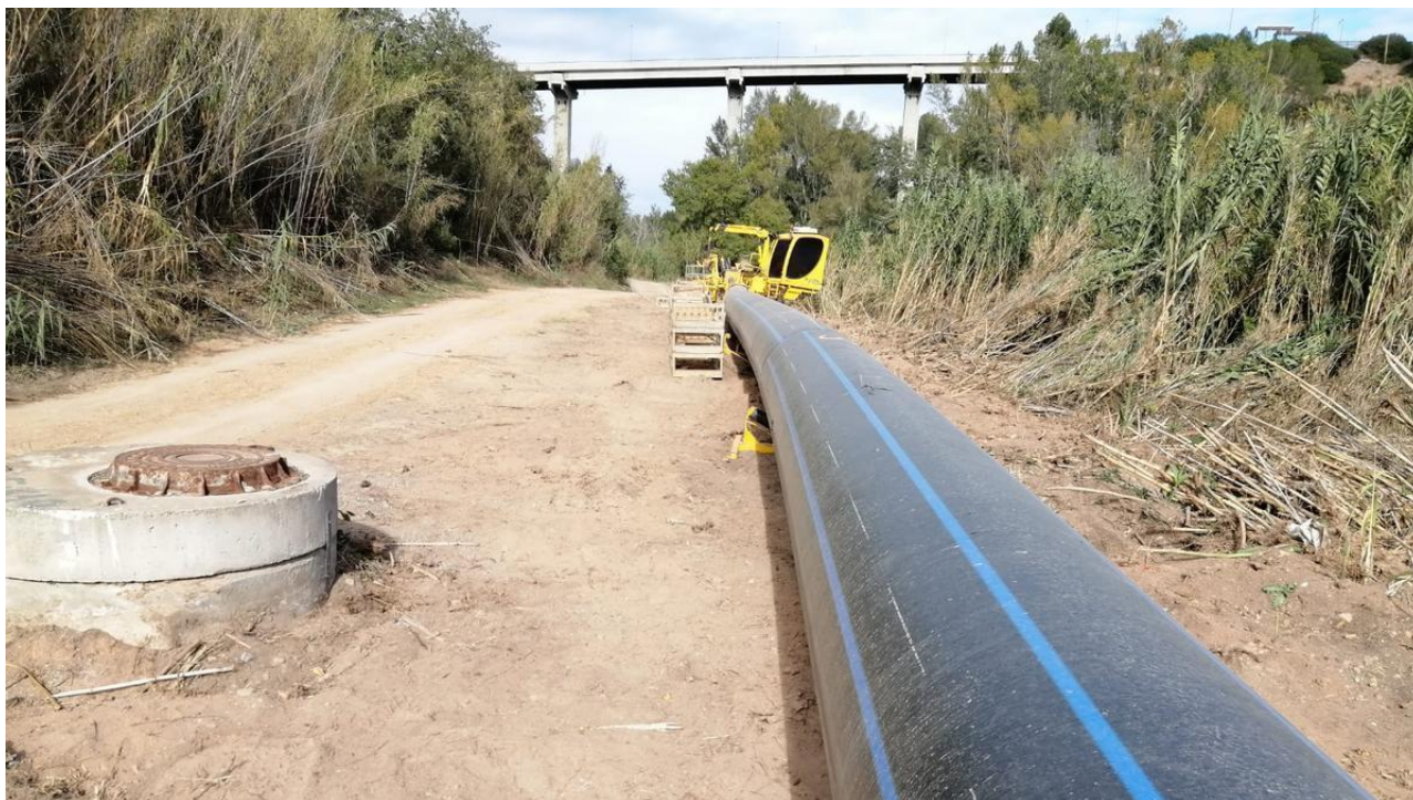
La canalització estesa al costat del riu, sota el viaducte d'accés a l'autopista. DAVID BRICOLLÉ
