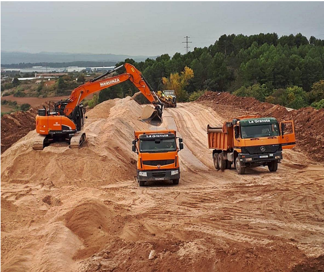
Màquines treballant en l'extracció de material al runam de la Botjosa icl
