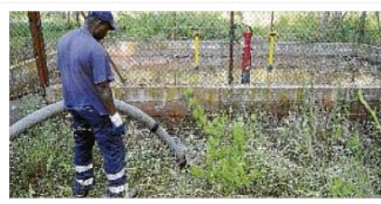
Un operari amb la mànega per bombar l'aigua salada prop d'una instal·lació, inundada, de Gas Natural SALVADOR REDÓ
